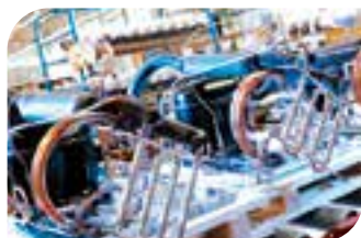
Ligne de chargement / vidange des groupes
